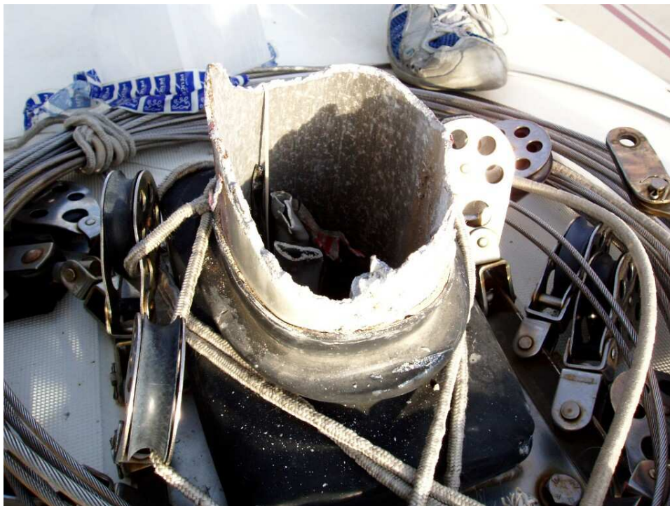
Mât : présence d'oxydation chimique au niveau de l'emplanture
